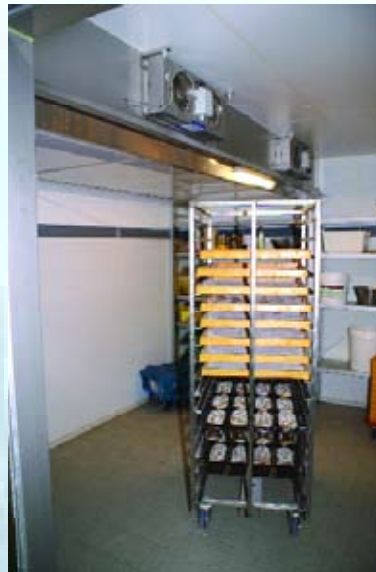
Die Kühlzelle für 14 Wagen liegt vor dem TK-Lager und wird ebenfalls zur kühlen Teiglagerung genutzt.
