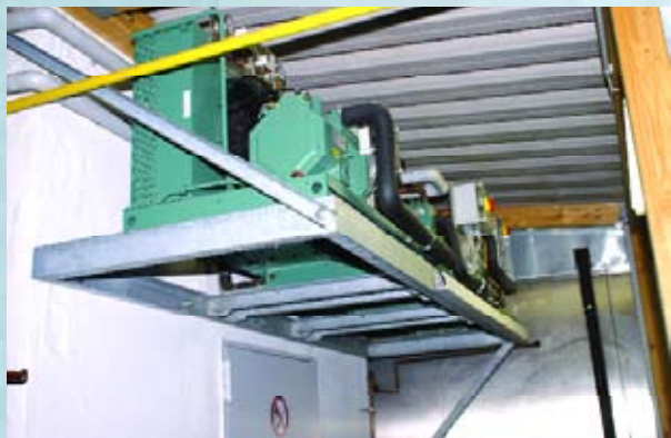
Die Kältemaschinen fanden ihren Platz unter einem Vordach.
