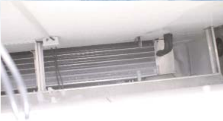
Beim Blick unter die Decke der Teiglagerzelle wird der Supracooler sichtbar.
