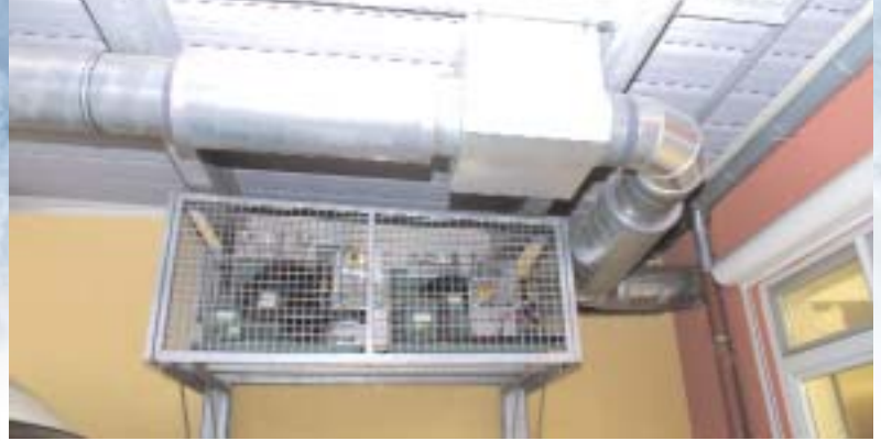
Die Maschinen wurden draußen untergebracht. Mit nur 45 dB (A) arbeiten sie sehr leise.
