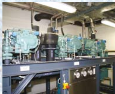
Die Leistung der Kältemaschinen wurde hoch dimensioniert.
